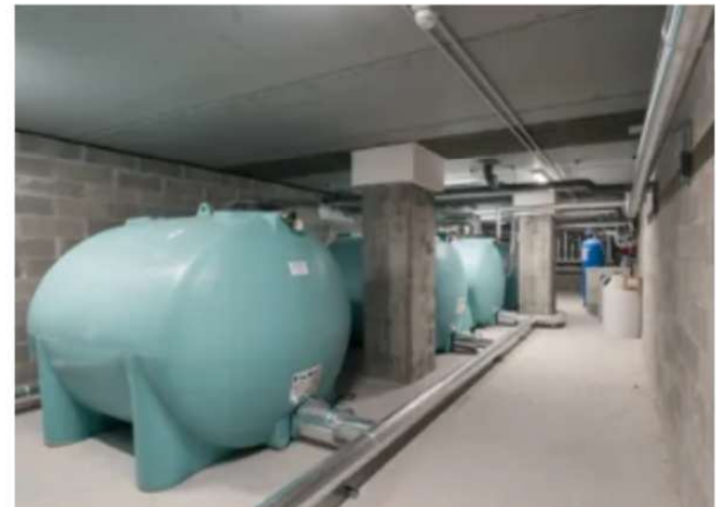
Dotazioni impiantistiche - Riserve idriche
