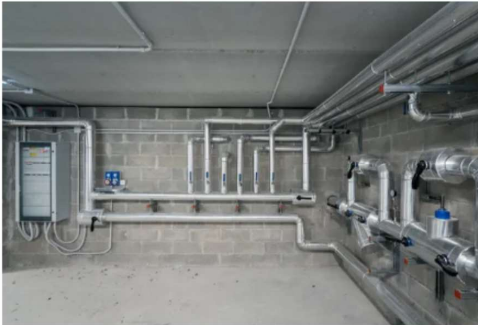
Dotazioni impiantistiche - Riserve idriche
