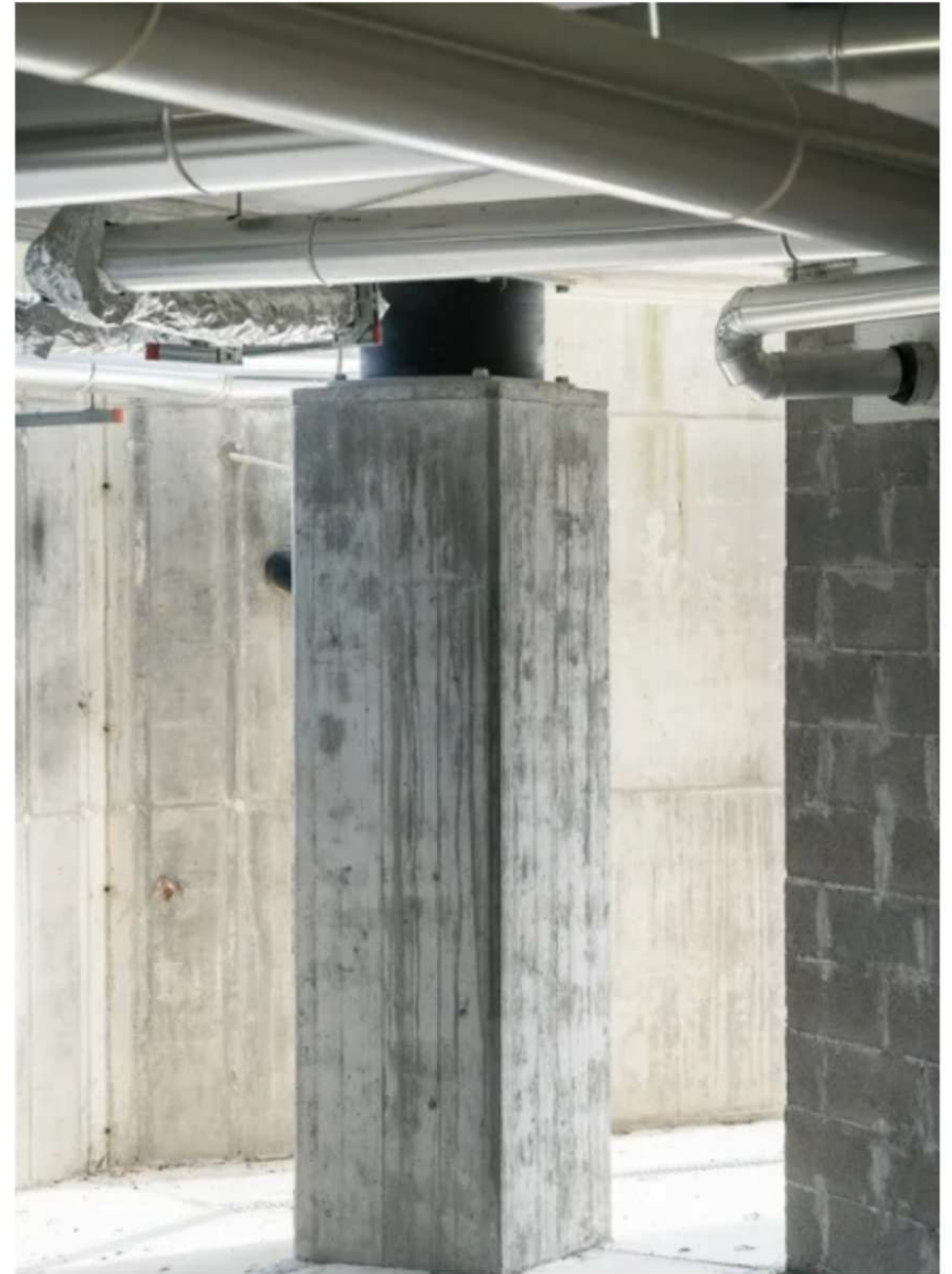
Piano interrato - Isolatori sismici
