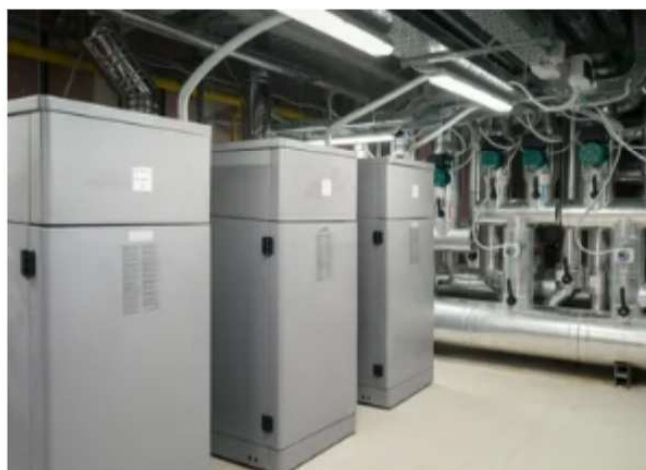
Centrale termica e caldaie
